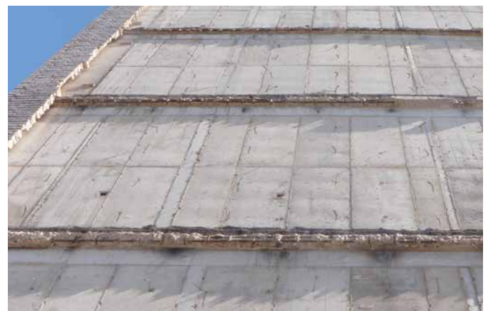
Vormauerschale komplett abgelöst; Drahtanker korrodiert | Mur de parement complètement détachée; ancre métallique corrodée
